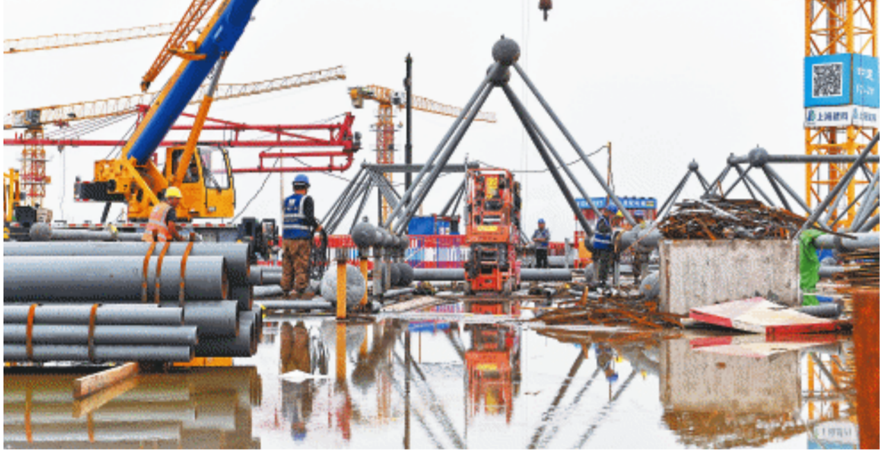
在长沙机场改扩建工程T3航站楼项目施工现场，建设者鼓足干劲，全力以赴推进项目建设。长沙晚报全媒体记者 王志伟 通讯员 赵成 摄影报道
