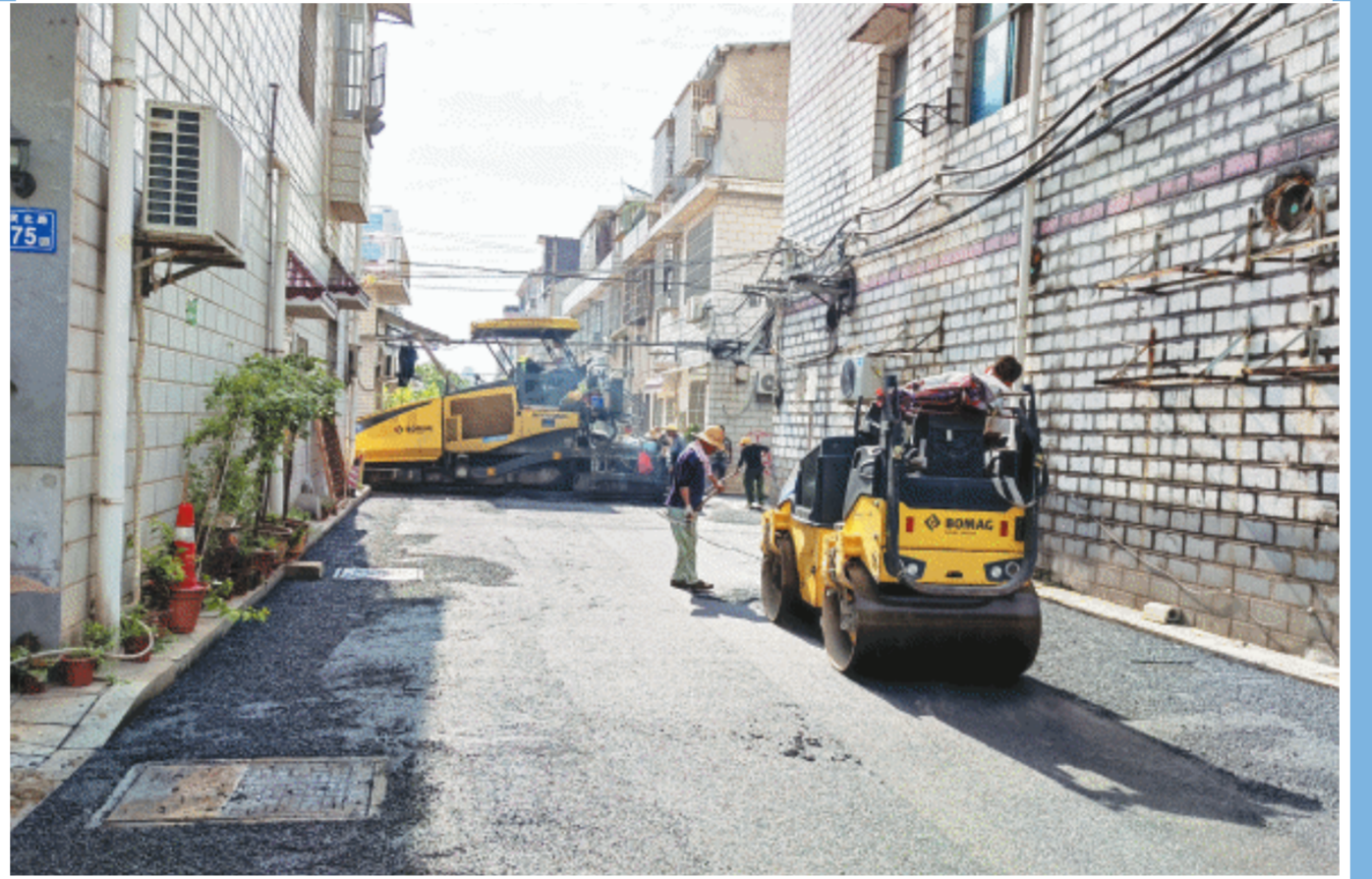
宁乡市交通运输局公路养护中心为联点帮扶的老旧小区改造道路。资料图片
