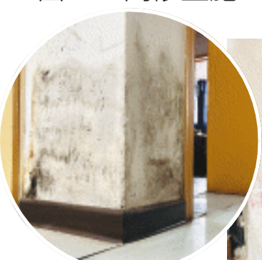
▲与卫生间相邻的墙体因渗水发黑，部分地板边缘翘起。
