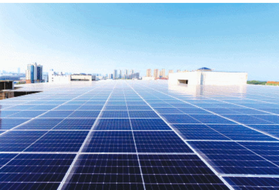
湖南广为建设有限公司投资建设的光伏发电项目。长沙晚报通讯员 郑骏 摄
