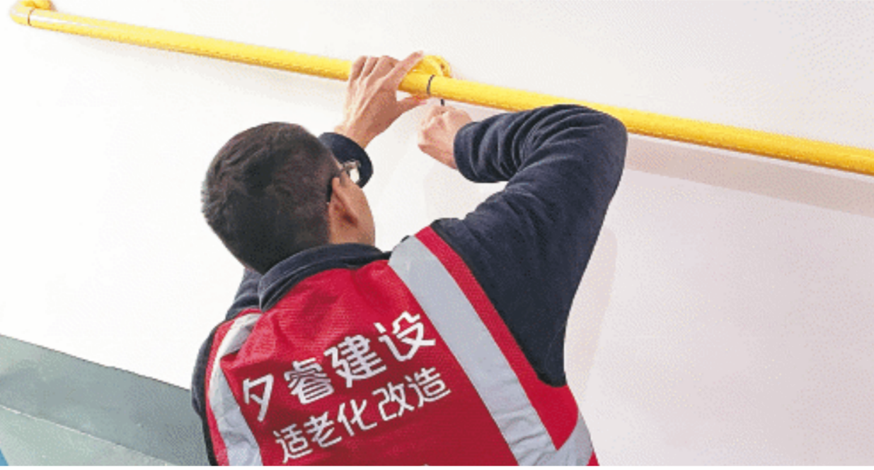
目前改造项目主要包括施工类、辅具类和智能类。工作人员正在安装扶手。长沙晚报全媒体记者 朱华 摄
