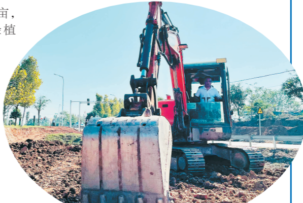
横一路与开福大道交会处的这块空地,垃圾、菜地被清理,将变身浪漫油菜花地。
