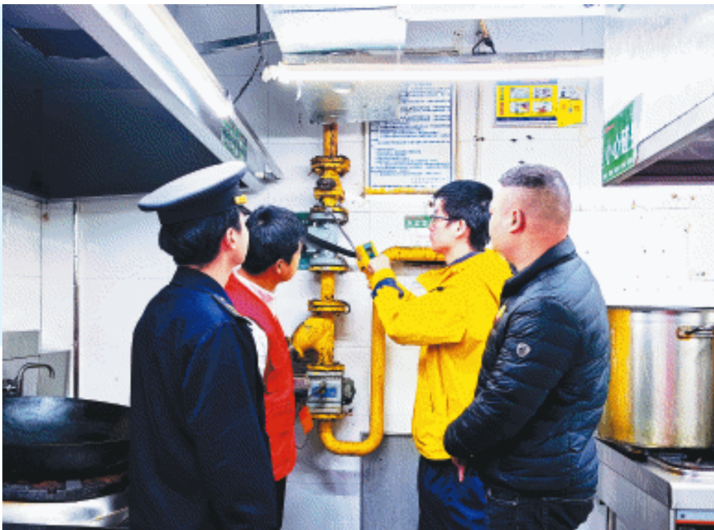
针对检查中发现的问题、隐患，长沙县要求相关主体单位整改到位，并及时开展排查整治“回头看”。图为工作人员在检查门店内燃气安全情况。长沙县泉塘街道供图
