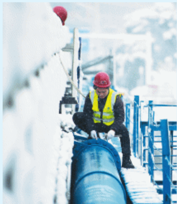
东屯渡浏阳河大桥上，来自长沙供水公司城东分公司的工作人员在桥上检查输水管线，确保供水线路稳定。 长沙晚报全媒体记者 黄启晴 摄
