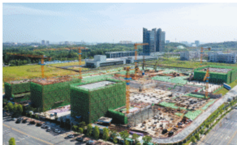
13日,金霞经开区消费电子产业集聚区003地块厂房项目2号栋主体结构顺利封顶。长沙晚报全媒体记者 王志伟 摄
