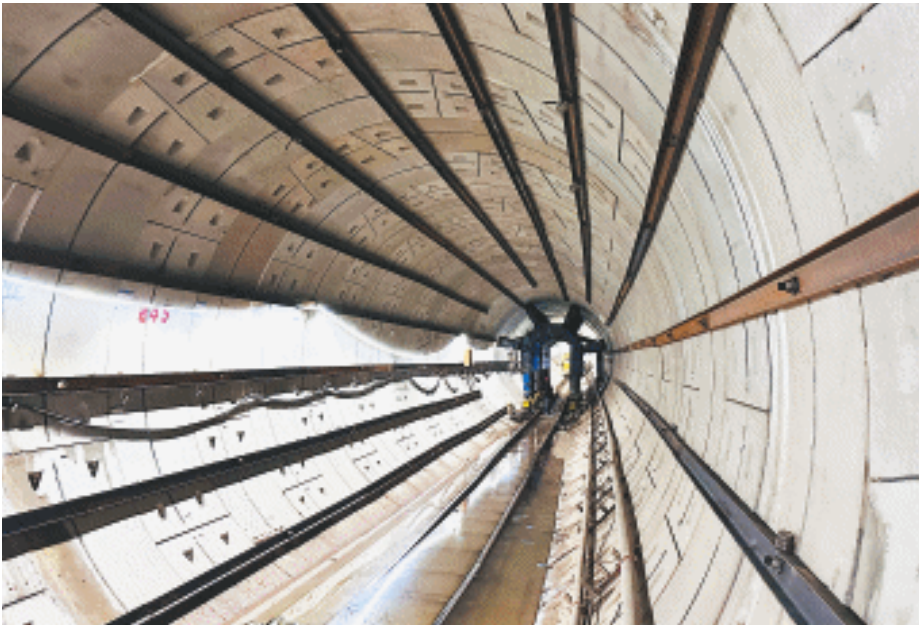
16日上午,地铁6号线东延段工程全线区间隧道贯通。 长沙晚报通讯员 侯建国 供图
