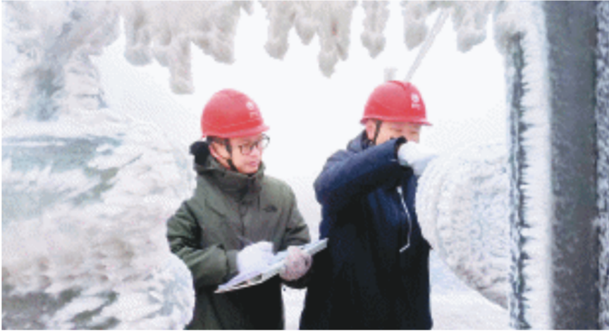
2月6日,在110千伏集关生线035号杆塔冰情监视哨,输电运检班人员连续多日驻扎哨点,对线路覆冰情况进行24小时观测。
