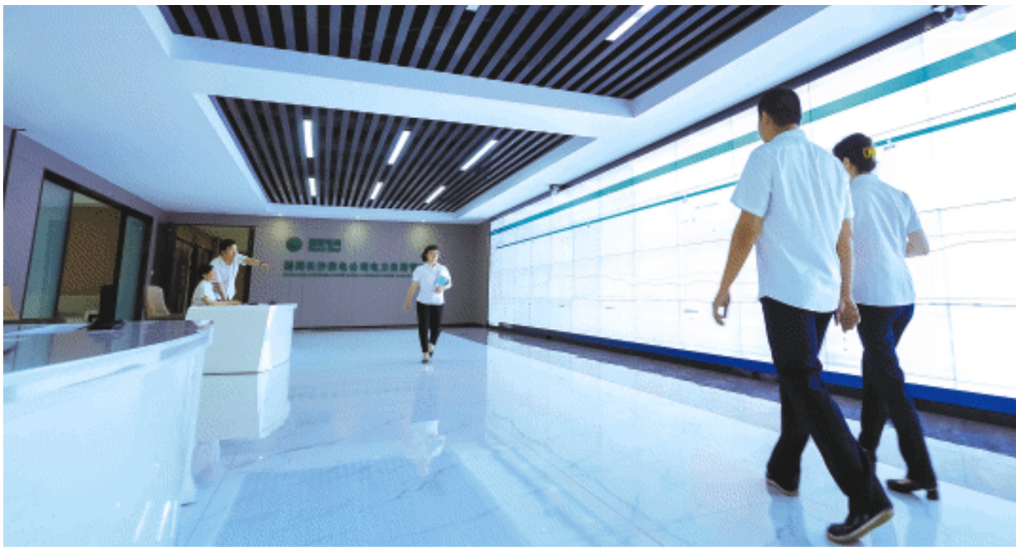
虚拟电厂管理中心的操作室有一个巨大的电子屏,虚拟电厂的发电控制、发电量、市场交易等信息一一直观显示。 受访方供图
