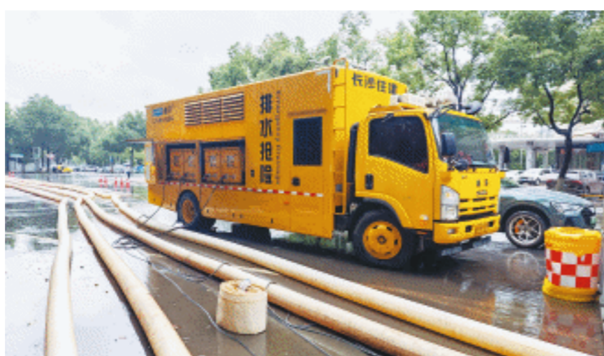
6月25日下午,红旗渠排水改造工程火炬路施工现场,排水车在排水。因大雨天气,该处排水改造工程地下开挖施工点被水淹,随后,相关部门调派排水车前来排水抢险。长沙晚报全媒体记者 贺文兵 摄
