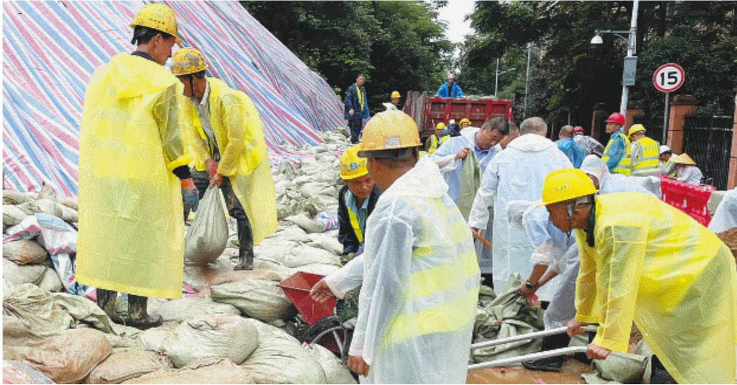
6月25日,天心区桂花坪街道一处护坡发生开裂,存在坍塌风险。图为抢险现场,工作人员正抓紧堆筑沙包。长沙晚报全媒体记者 吴鑫矾 摄
