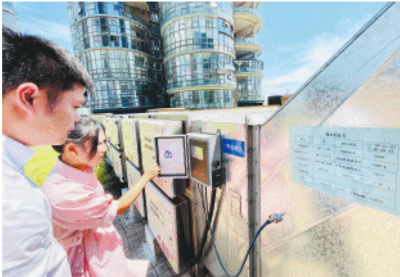
排口连接“绿岛”处，连接了Wi-Fi的液晶显示屏上，实时排油烟数值、设备状态、责任单位等信息一目了然。均为长沙晚报全媒体记者 李卓 摄
