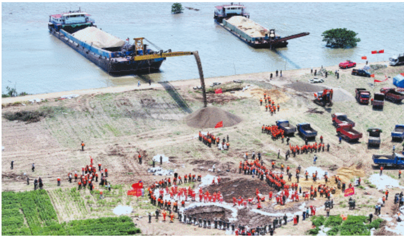
7月8日，抢险人员在钱团间堤管涌险情现场进行紧急处置(无人机照片)。新华社记者陈泽国摄
