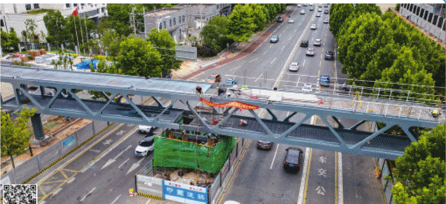
7月13日,长沙首座双层人行天桥——跨木莲中路人行天桥完成主体合龙。长沙晚报全媒体记者 易亿 摄
