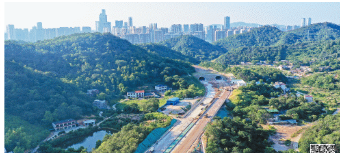
梅浦联络线项目北起梅溪湖路西延线，止于含浦片区象嘴路，全长4.45千米。长沙晚报全媒体记者 王志伟 实习生 周睿霖 摄影报道
