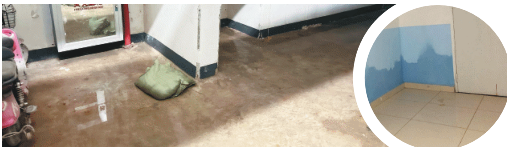
小区地下车库负一层,仍有少量积水。均为长沙晚报全媒体记者 邓艳红 摄
