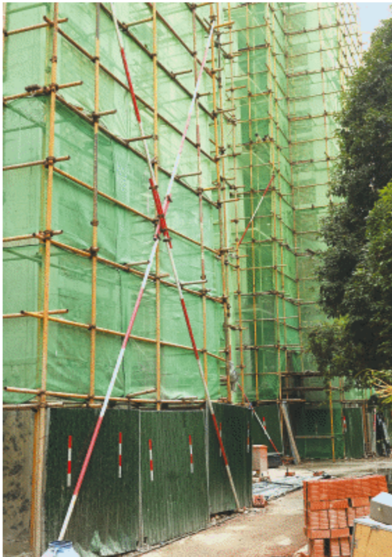
记者在现场看到，一楼电梯口堆积着不少建筑材料，周边搭建着脚手架和绿色围挡，未见有工人施工。 长沙晚报全媒体记者 罗悦 摄
