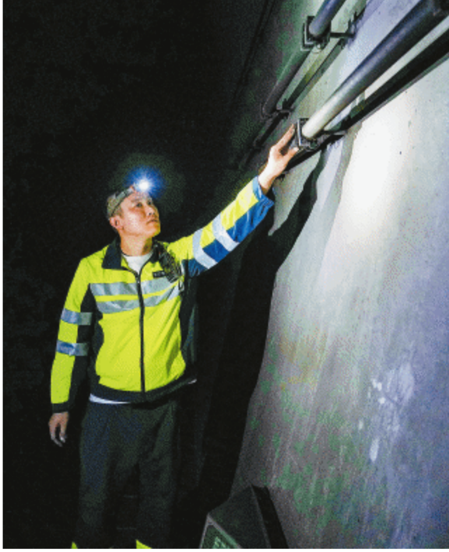
黑暗的隧道内，高铁通信工正在检查设备。长沙晚报通讯员 游智宇 阳云志 供图
