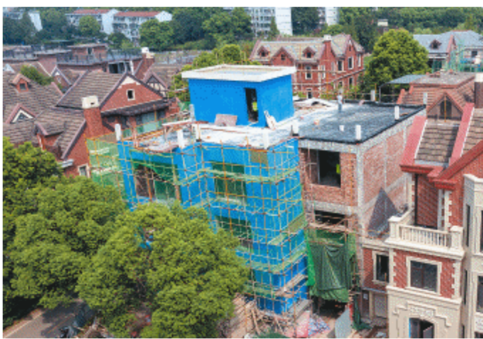
该别墅业主未经许可,在一层车库上方加盖了两层房屋。长沙晚报全媒体记者 周数邑 摄
