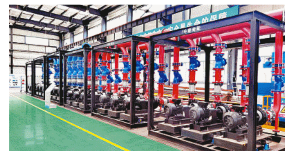
“中建奇配”装配式集成模块化制冷机房技术,相比传统方式可缩短建模时长约70%。资料图片
