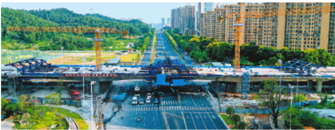
兴联路大通道（过江段）项目河西、河东引桥近日全部贯通。长沙晚报全媒体记者 王志伟 摄
