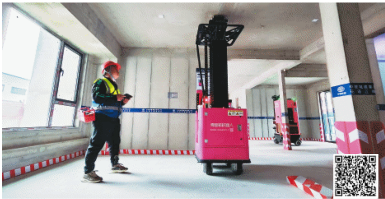
一名工人正在操控混凝土天花打磨机器人作业。长沙晚报全媒体记者 孙占锋 摄
