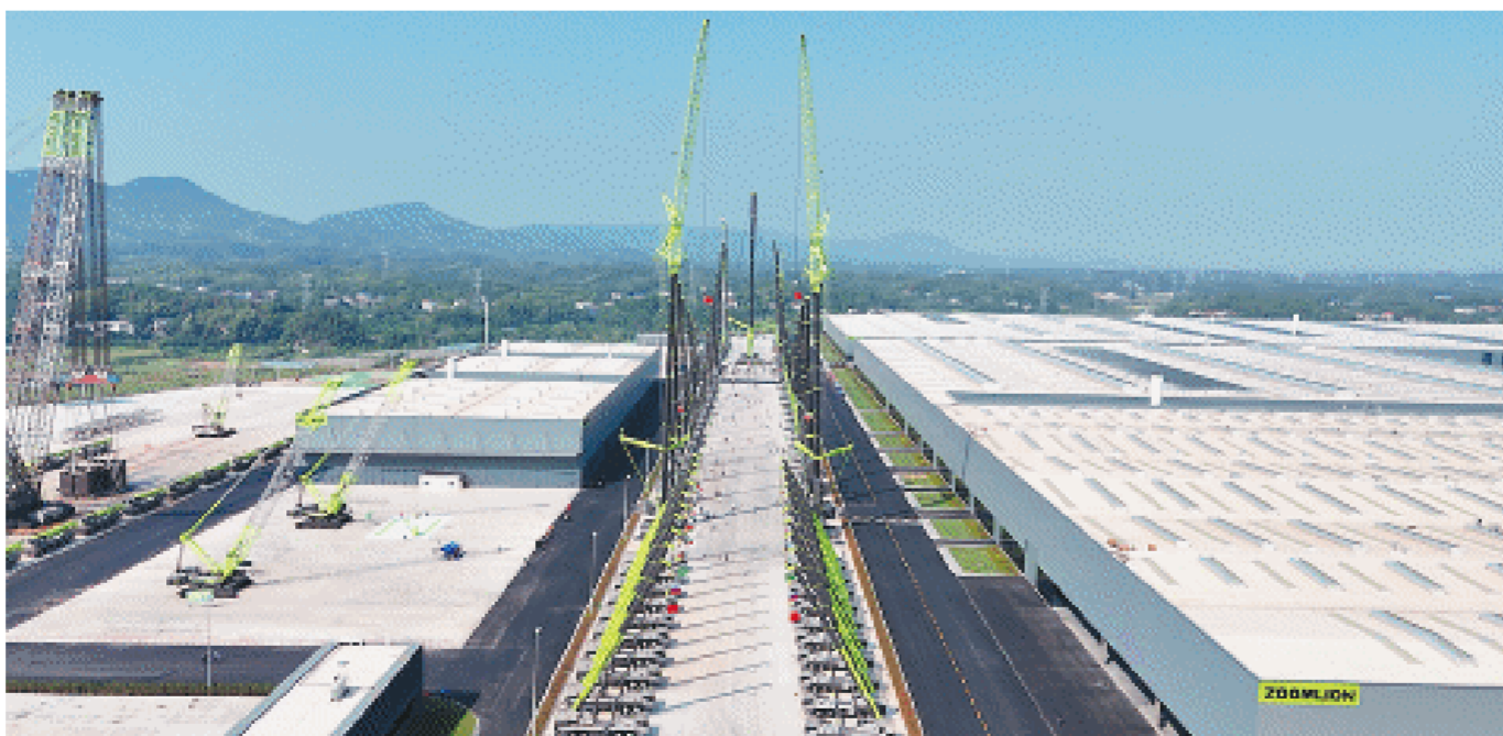
本次重大项目集中开竣工活动,长沙14个竣工项目完成投资571亿元,包括中联智慧产业城、三安半导体产业基地等重大产业项目。图为中联智慧产业城。 中联重科供图
